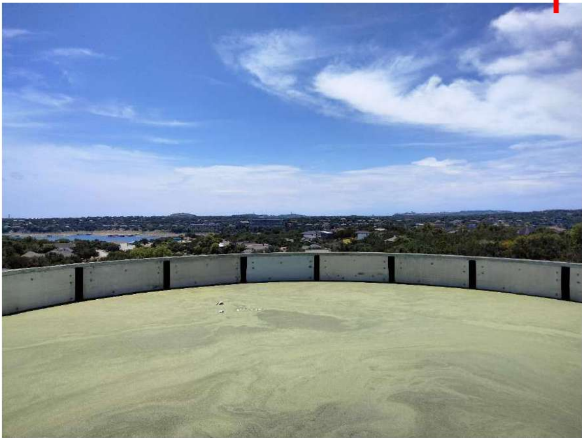
2024.07.18, Effluent Surface Level of GST
